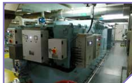
钻井平台生活污水处理装置
